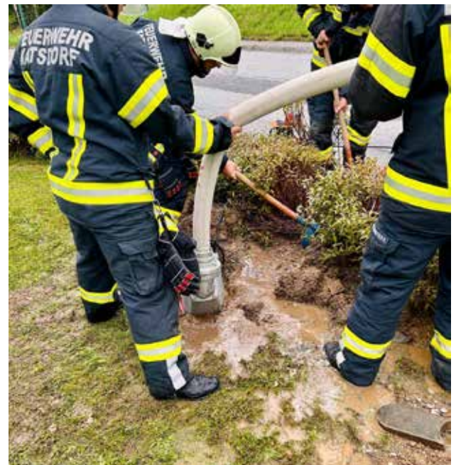
Einsatz der Feuerwehr Katsdorf bei einem Rohrbruch
